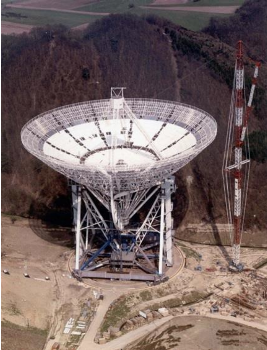
Abb. 15: Radioteleskop Effelsberg im Bau. Der Montagekran auf der rechten Seite hat eine Gesamthöhe von 130 m. (Foto: MPIfR/Arge Krupp/MAN).
